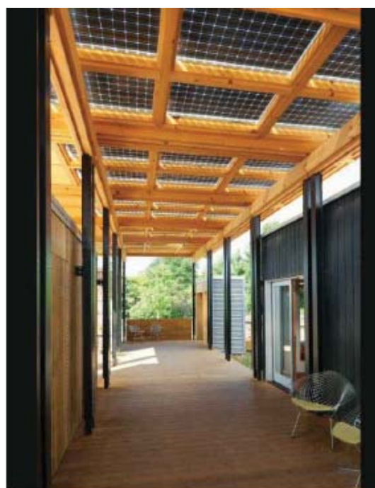
PASSADÍS EXTERIOR AMB COBERTA FOTOVOLTAICA
