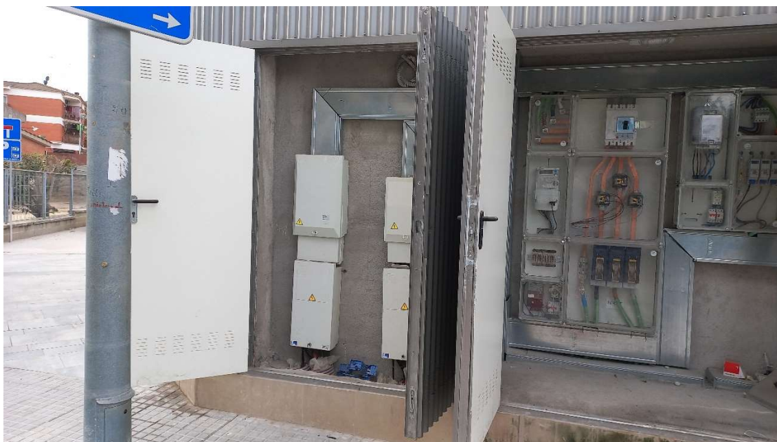
Imatge 4. Armaris dels equips de protecció i mesura
